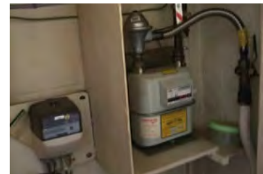
Brannisolasjon av skap
